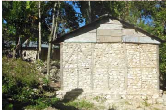
Exemple d'appropriation des améliorations techniques dans la construction de l'habitat rural. Parfois, les habitants modifient ces améliorations pour les optimiser selon leurs moyens économiques. Ici le contreventement est partiel et astucieusement placé en parties supérieures.
