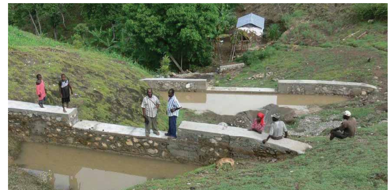
Réalisation d'un seuil en gabions à Boucan Richard, Gros-Morne - Crédit photo : SOS Enfants sans Frontières et Zanmi Lasanté Paris
